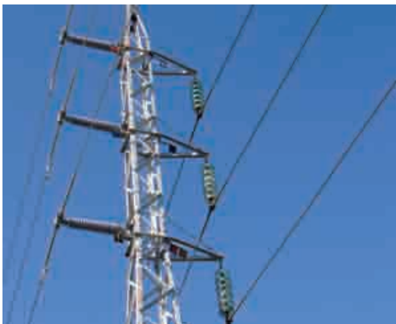
Vista parcial do Ramal Duratex da CPFL, Jundiaí - SP.
