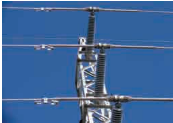
Suspensão dos condutores com Acessórios PLP.
