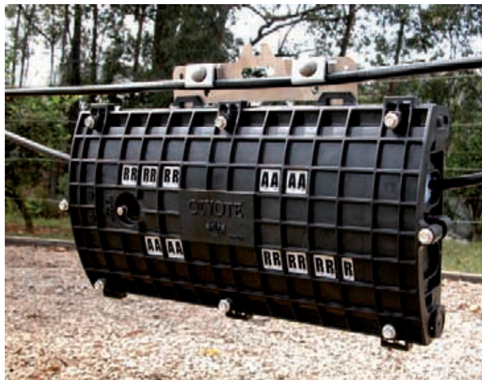
Caixa Terminal Óptico - CTO In-Line instalada.
